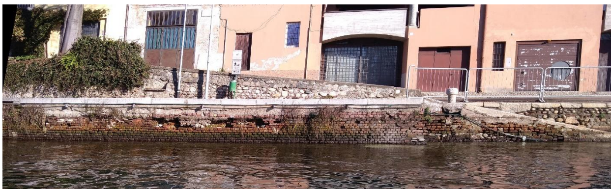
Figura 28 – Vista frontale del paramento a monte dell'approdo, con segno di cedimenti della muratura.
