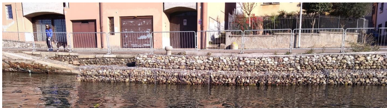
Figura 25 – Vista frontale del manufatto di approdo con interventi provvisori di messa in sicurezza.
