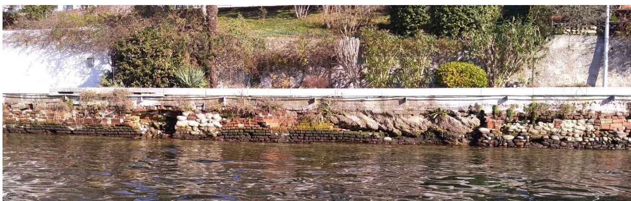
Figura 29 – Vista frontale del paramento tratto terminale di intervento, con segno di cedimenti della muratura.
