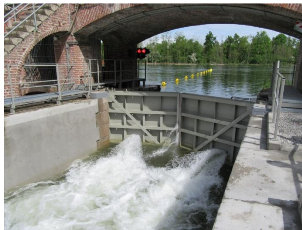
Foto 2: Prove di funzionamento del portone di monte - 04.2015
