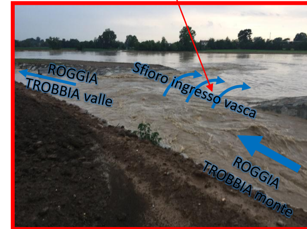
RIBASSO ARGINE DX ROGGIA TROBBIA INGRESSO VASCA
